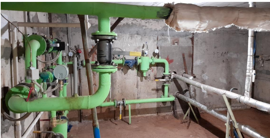
Фото 6. Тепловой узел в МКД по ул. Промышленная, 55. Фото ИЭГ
