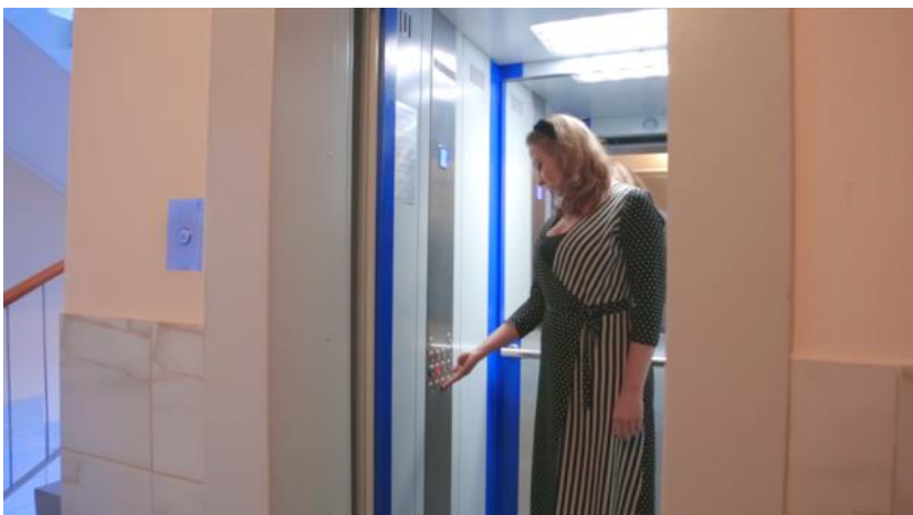
Фото 3. Новые лифты в МКД № 4 по ул. Башкирская, г. Ростов-на-Дону. Фото ТСЖ «Башкирская-4»
