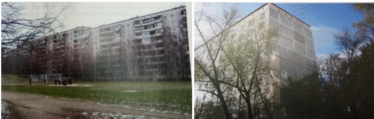
Фото 2-3. Состояние фасада многоквартирного дома до капитального ремонта. Фото ИЭГ
