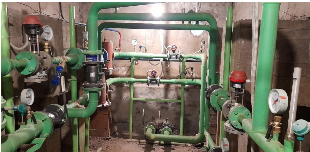
Фото 2. Автоматизированный тепловой узел в МКД по ул. Промышленная, 38. Фото ИЭГ
