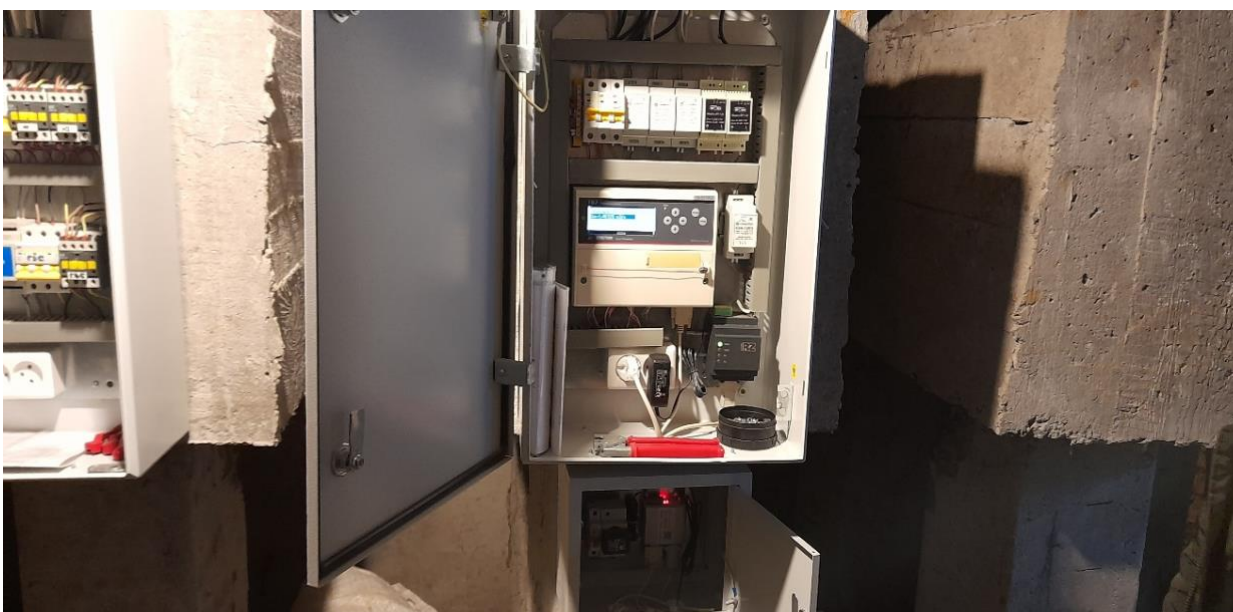
Фото 3. Щиты дистанционного управления теплоподачи в МКД по ул. Промышленная, 38. Фото ИЭГ
