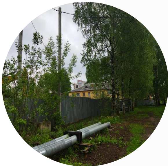
ОТСУТСТВИЕ ИЛИ ВЕТХОСТЬ ИНЖЕНЕРНЫХ СЕТЕЙ
